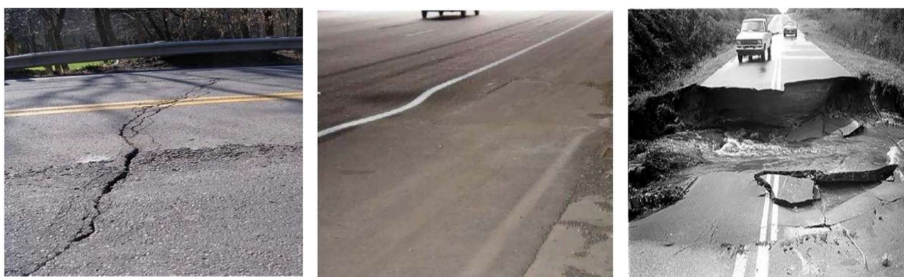
а) тріщини дорожнього покриття б) просідання конструкції дорожнього одягу в) руйнування конструкції дорожнього одягу
